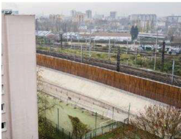
Aménagement d'un écran acoustique sur le domaine ferroviaire en interface avec la cité Paul Eluard - Projet SNCF - Saint-Denis (93)
