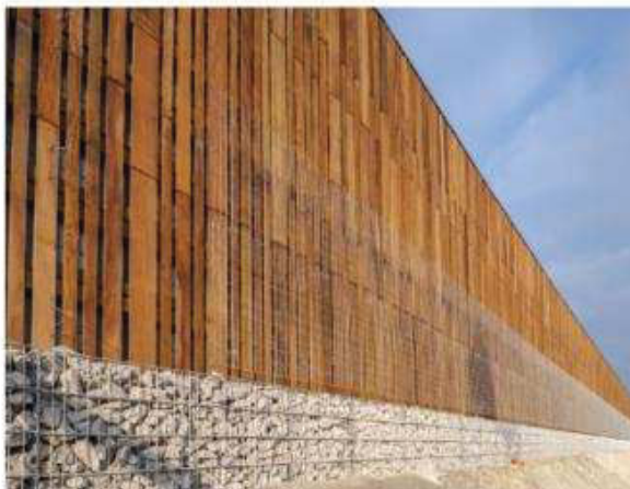
Aménagement d'un écran acoustique sur le domaine ferroviaire en interface avec la cité Paul Eluard - Projet SNCF - Saint-Denis (93)
